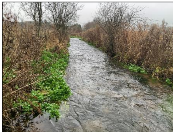
Foto 8. Nedstrøms Herredsvej ligger et stort betonstryg med næsten 1 m fald over en kort 100 strækning. Foto mod nord.
