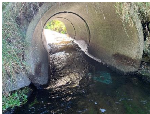
Foto 2. Potentiel faunaspærring ved rørunderføring ved Fårebrovej i Skravad Bæk. Foto mod syd.
