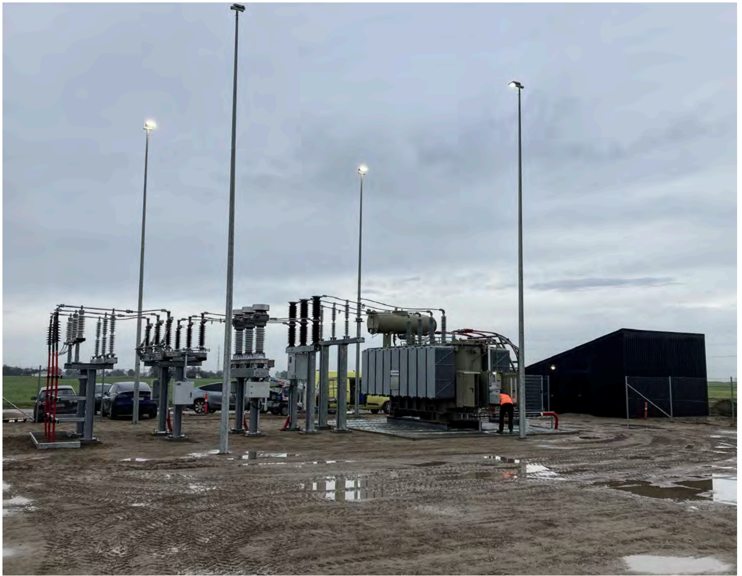
60/33kV stationen fra Nr. Øksesø det er en 50MVA transformer - Eurowind projekt
