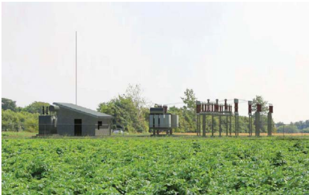
Figur 5.6: Eksempel på stepup-transformer med tilhørende 12 meter høj lynafleder omkranset af trådhegn, inden afskærmende beplantning er etableret.
